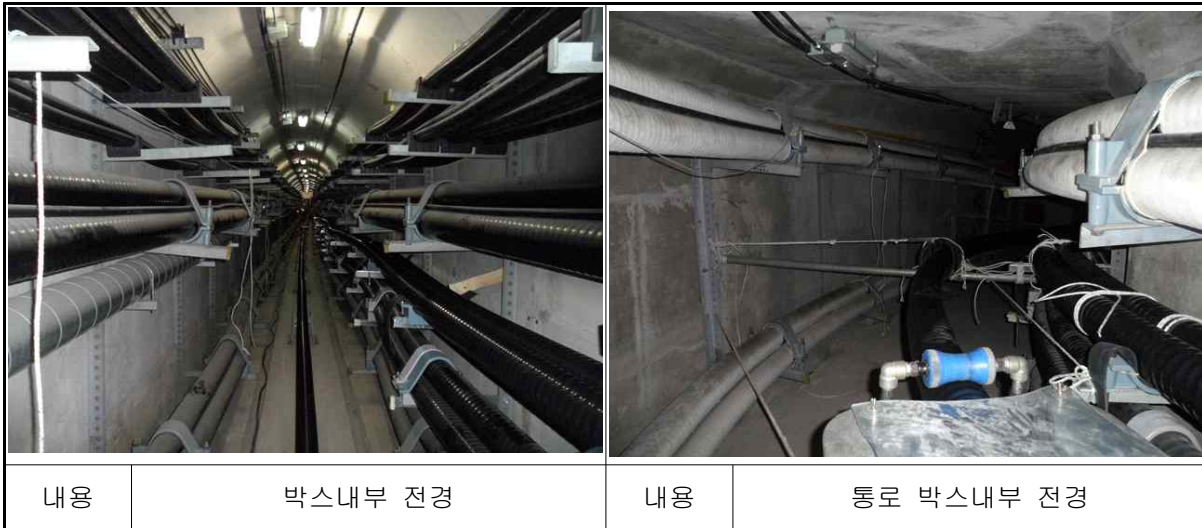
【사진 1.1】 구리인출 전력구 현황
