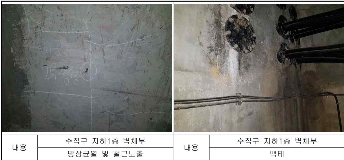
【사진 1.3】 구리인출 전력구 수직구 손상현황
